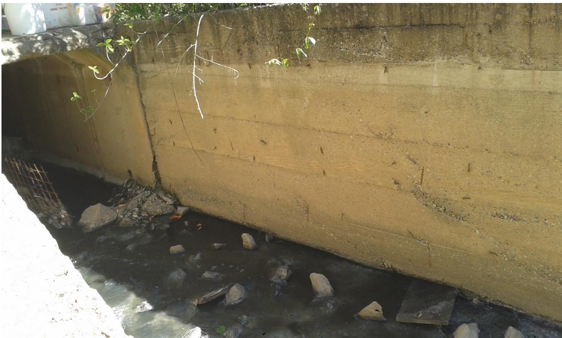
Figura – Rede pluvial com esgoto indevido lançado no Rio Mandú (fundo Sesi)
