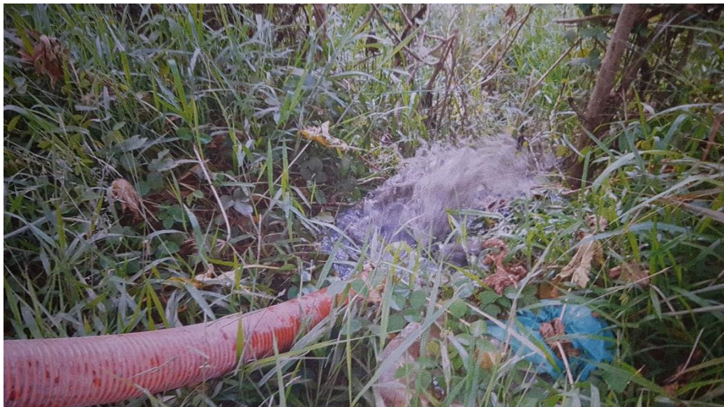
Figura –Lançamento de esgoto in natura em corpo hídrico por caminhões da Copasa (março/2017)
