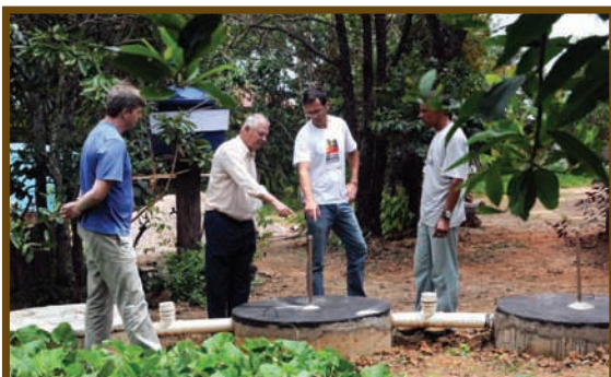
Suspiros são instalados na primeira e na segunda caixas para liberar gás metano
